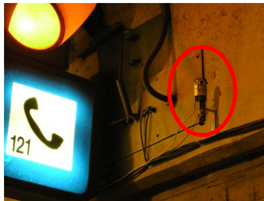
Abbildung 12 Für die Entwicklungsphase zusätzlich installierte Videokamera (Web-Cam) zur visuellen Kontrolle der aktuellen Situation im Tunnel
