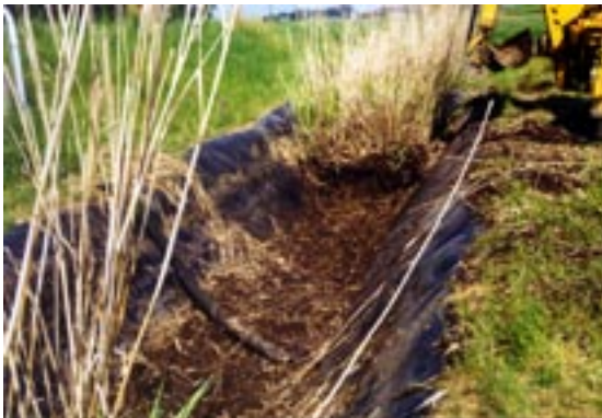
Abb.12: Geräumte Vererdungsbecken (Betonbecken und Erdbecken) Restschicht von 10 - 20 cm Klärschlamm mit Schilfrhizomen verbleibt im Becken
