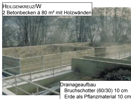
Abb. 16: Aufbau der Schlamm-trockenbecken in Heiligenkreuz
