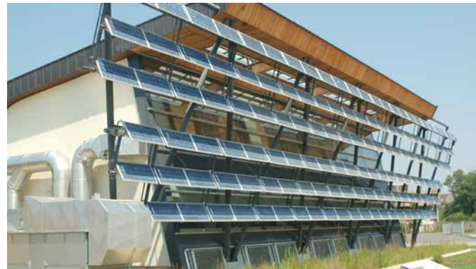
Desiccant-Klimaanlage, die gemeinsam mit dem Oekopark Hartberg entwickelt wurde.
