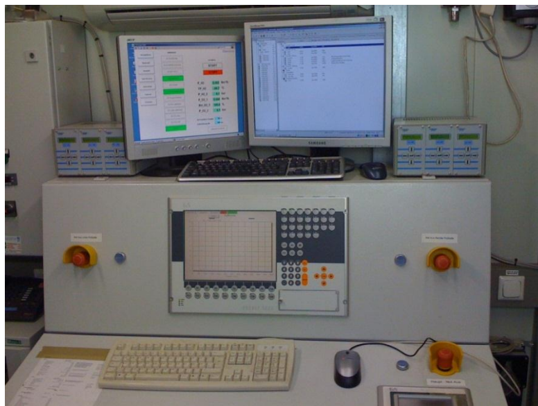
Abbildung 3-18: Ausstattung Messdatenerfassung im Prüfcontainer
