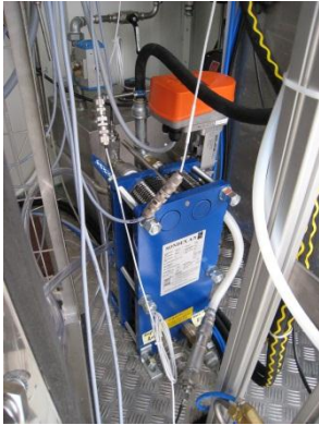
Abbildung 3-32: Plattenwärmetauscher und Mischventil MV_2
