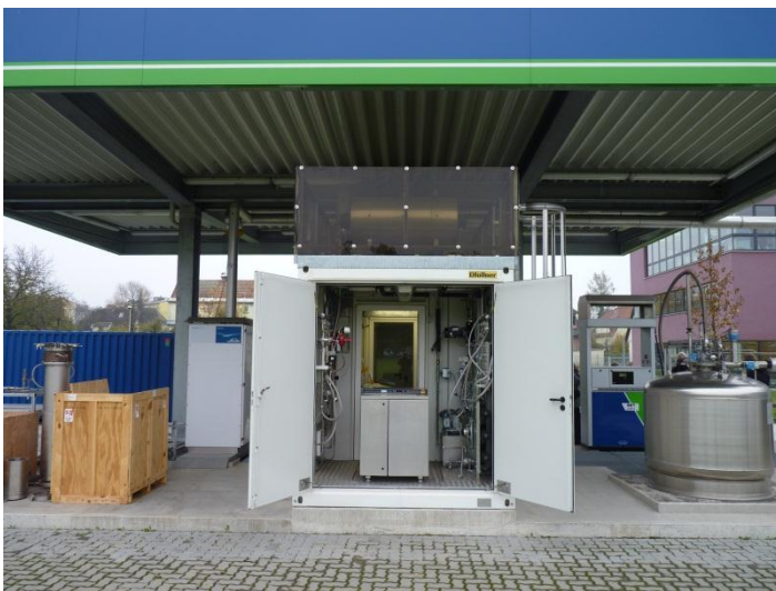
Abbildung 3-26: Prüfcontainer mit Elektrolyseur
